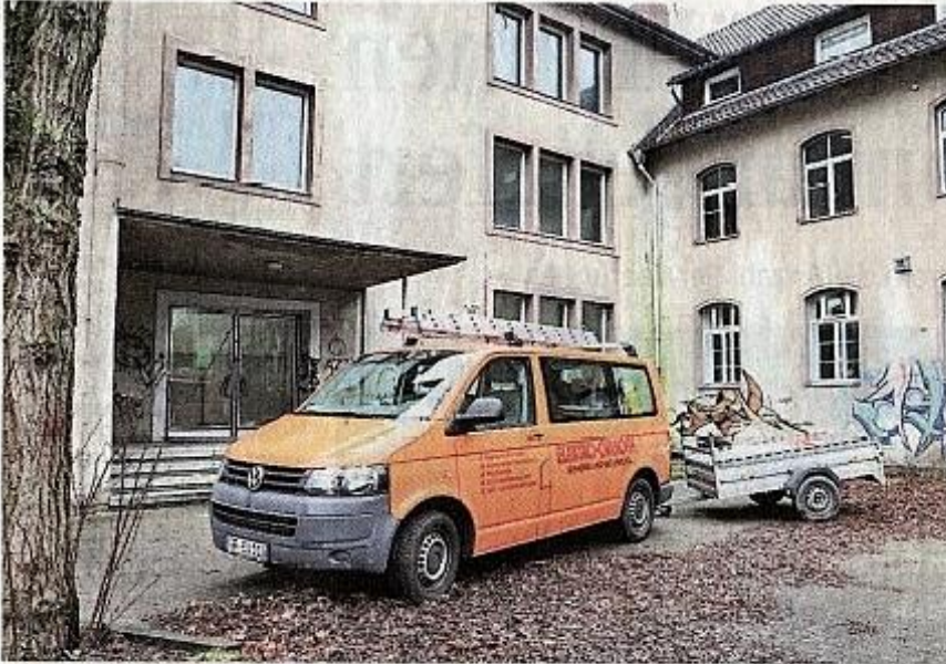
Noch eine große Baustelle: Die ehemalige Fritz-Reuter-Realschule wird umfassend renoviert, bevor am 1. Februar die Schüler der BBS 1 einziehen.
